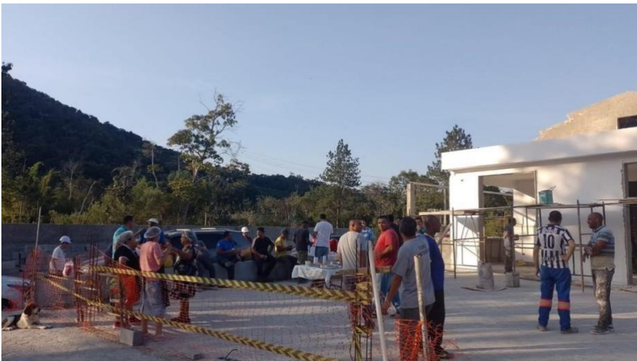
Figura 2: Conforme a NR 18 (Condições e Meio ambiente de trabalho na indústria da construção), a imagem mostra uma área de obra com isolamento parcial por fitas e telas de sinalização, porém observa-se grande circulação de pessoas, descumprindo a NR 6 (Equipamentos de Proteção individual – EPI) sem o uso adequado de EPIs, além de andaimes sem guarda-corpo e sinalização específica, sendo necessário reforçar as medidas de segurança, controle de acesso e proteção coletiva no local.
