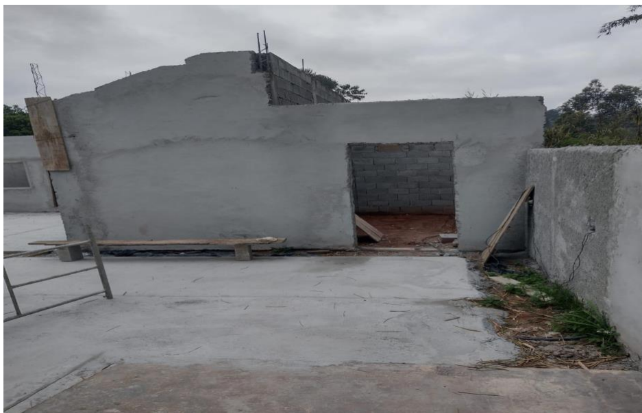
Imagem 6: Na imagem, observa-se uma construção em andamento, com paredes parcialmente erguidas e madeiras apoiadas nas extremidades superiores, sugerindo possíveis atividades em altura. Pontos de atenção
