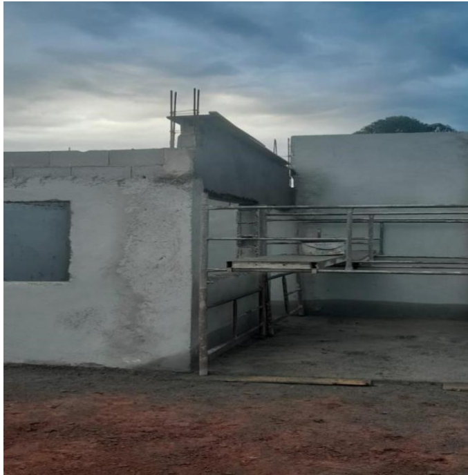
Figura 3: Durante a inspeção de segurança, foi constatado que o andaime instalado não está em conformidade com os requisitos estabelecidos pelas Normas Regulamentadoras, especialmente a NR 18 e NR 35. A estrutura encontra-se sem a devida sinalização de segurança, como fita zebra e cones para isolamento da área, o que compromete a identificação da zona de risco e expõe os trabalhadores e demais pessoas à possibilidade de acidentes."
