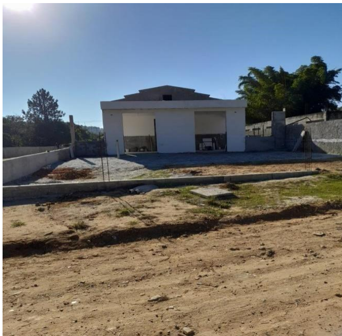
Figura 4: obra não está atendendo aos procedimentos corretos de segurança, apresentando ausência da tela de proteção necessária nas estruturas. A falta desse dispositivo compromete a segurança dos trabalhadores e contraria as normas regulamentadoras aplicáveis, sendo imprescindível a sua instalação imediata para garantir a integridade física de todos no local.
