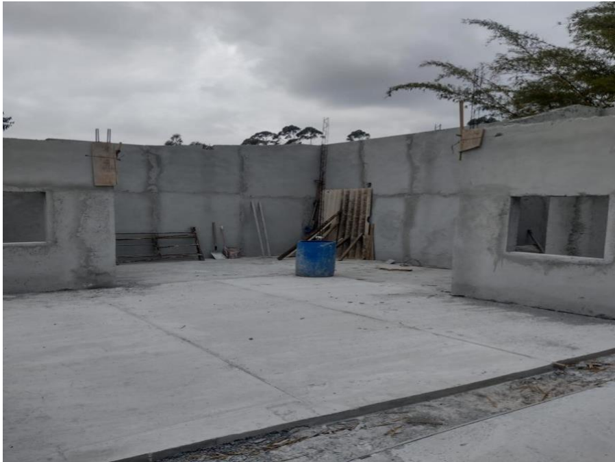
Figura 5: Na imagem, observa-se uma estrutura metálica (andaime) sendo utilizada como apoio para materiais. Apesar de não haver trabalhador visível, a montagem indica potencial atividade em altura. Segundo a NR35, identificam-se os seguintes pontos de atenção: Ausência de guarda-corpo e rodapé na estrutura, o que representa risco de queda. Andaime aparentemente sem travamento e sem base nivelada ou sapatas, podendo comprometer a estabilidade. Falta de sinalização e isolamento da área, o que é necessário para evitar acesso indevido.
