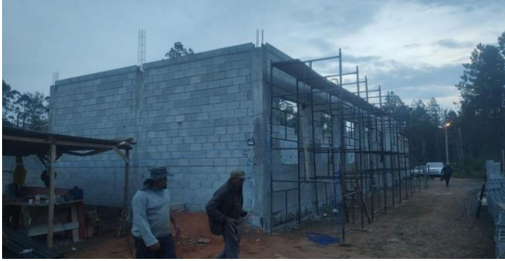
Figura 1: Conforme NR 18 (Condições e Meio Ambiente de Trabalho na Indústria da Construção) e NR 35, observa-se que os andaimes precisam de guardacorpo, rodapés e travamentos adequados.
