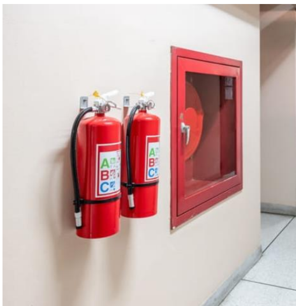
Figure 14 - EXTINTORES E HIDRANTES
