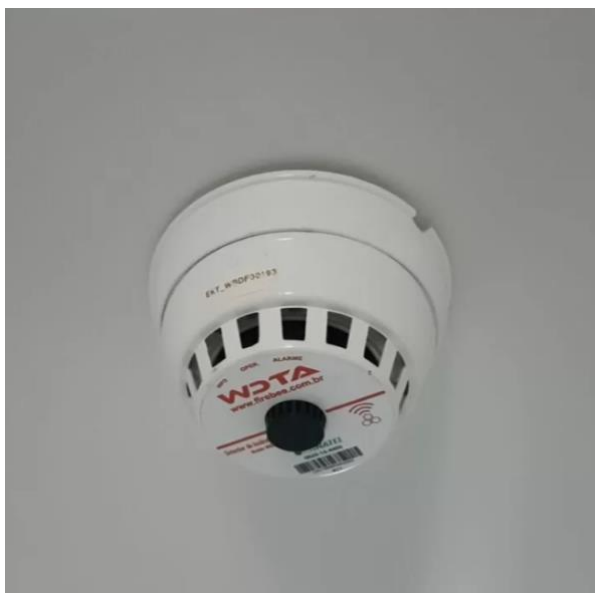
Figure 15 - ALARMES DE INCÊNDIO E DETECÇÃO DE FUMAÇA
