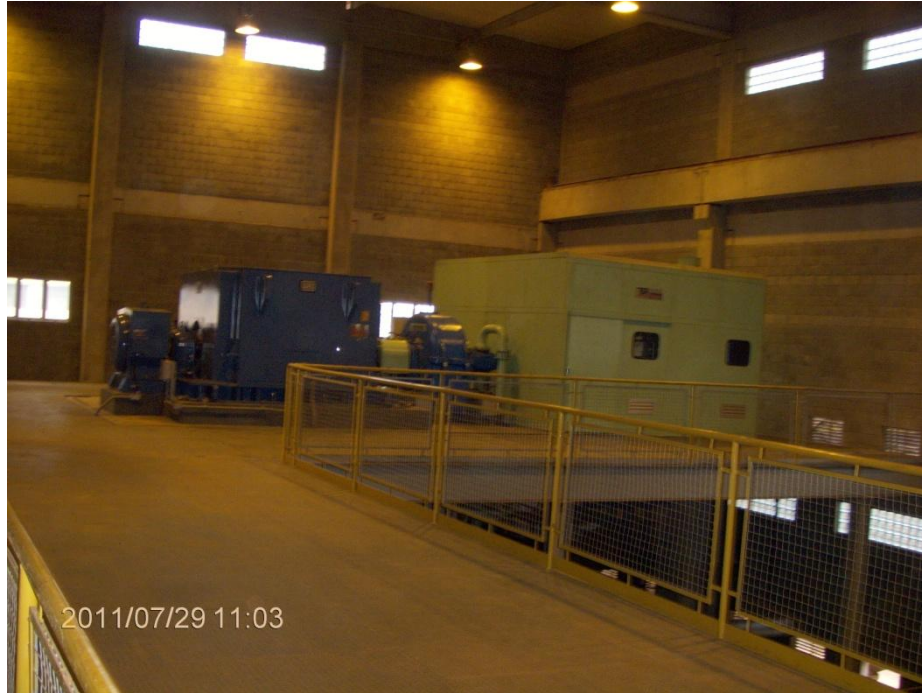
Figura 16 - Interior da casa de Força (AMARAL, 2012)
