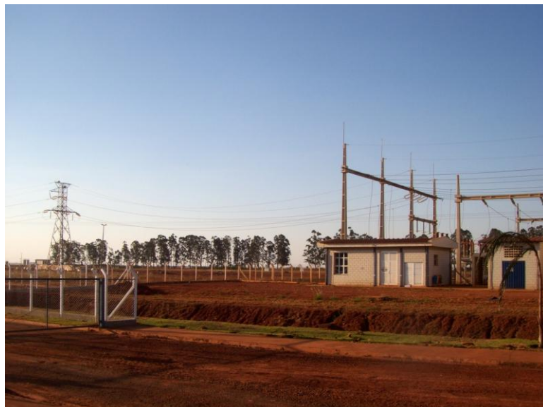
Figura 15 - Vista geral da subestação e rede de transmissão (AMARAL, 2012)
