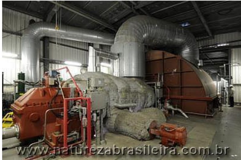
Figura 12 – Turbina instalada (KOCH, 2012)
