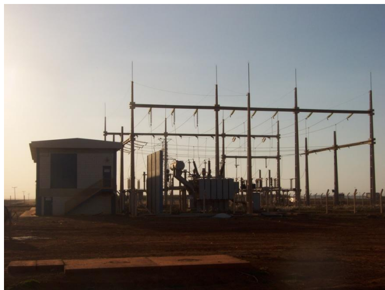
Figura 13 - Subestação seccionadora (AMARAL, 2012)
