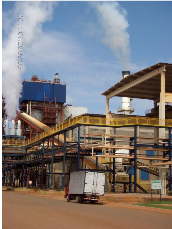
Figura 7 - Vista geral da saída de bagaço e caldeira (AMARAL, 2012)
