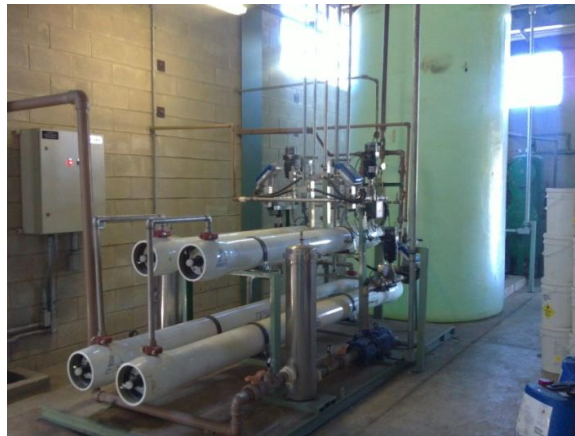
Figura 19 - Equipamento utilizado para tratamento de água por osmose reversa (AMARAL, 2012)
