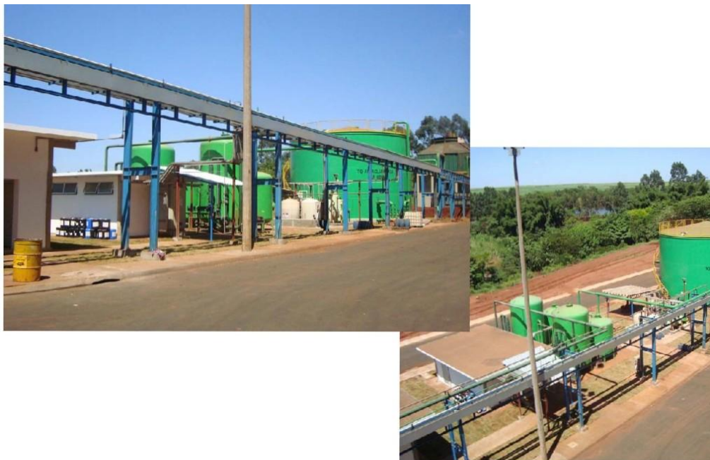
Figura 18 - Vista geral da estação de tratamento de água (AMARAL, 2012)
