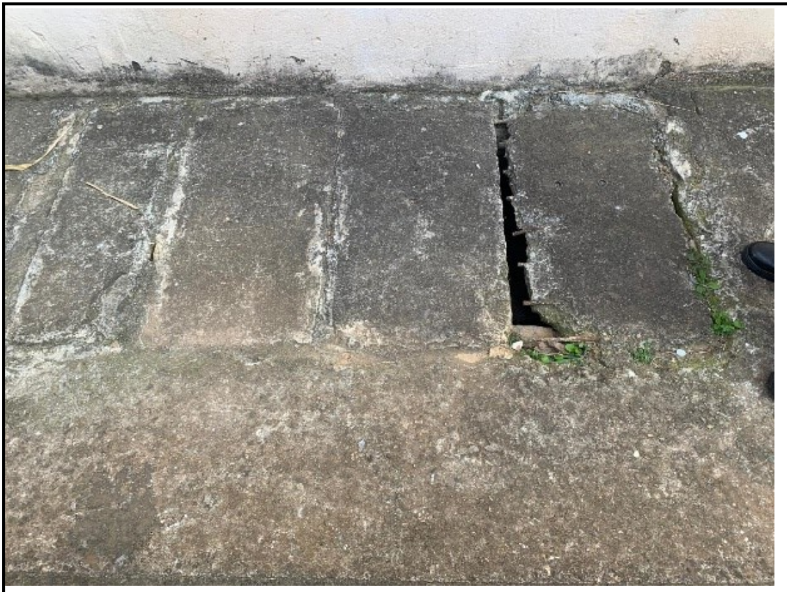
Imagem 37 - Placas mecânicas danificadas.
