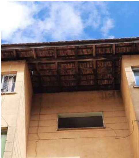
Fig.44: Telhas quebradas – Foto de 21/06/25
