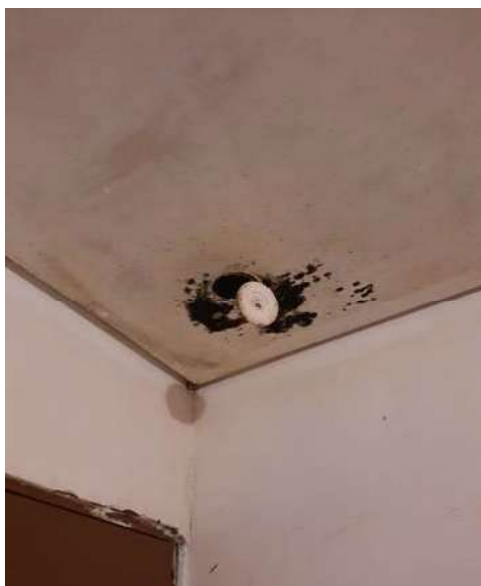
Fig.46: Infiltração – Foto de 20/06/25
