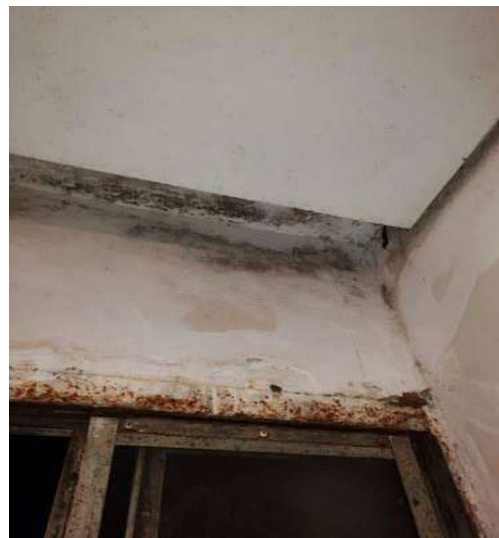
Fig.45: Infiltração – Foto de 20/06/25
