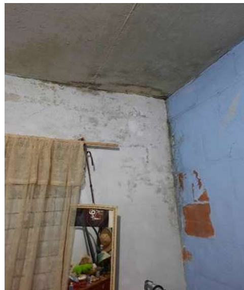
Fig.47 Infiltração – Foto de 20/06/25
