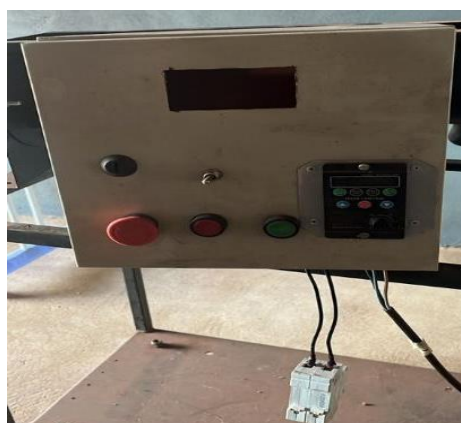
Figura 3 – Painel de comando. Fonte: Autoria própria.
