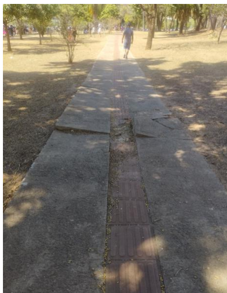
Figura 7 – Pista de caminhada em péssimo estado de conservação
