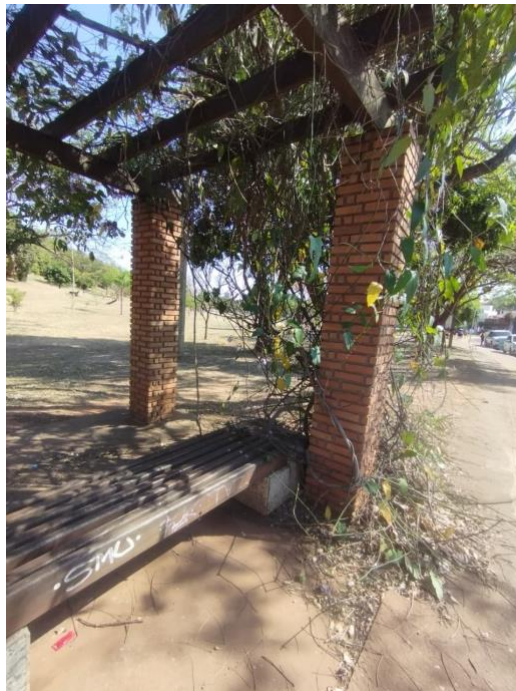
Figura 5 – Espaços para recreação em péssimo estado de conservação
