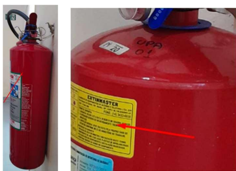
Figura 3 e 4 – Extintor água
