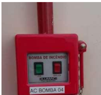
Figura 8 – Bomba de incêndio
