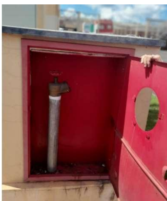
Figura 5 – Dispositivo de recalque na calçada de Frente a UPA
