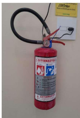
Figura 2 – Extintor pó químico
