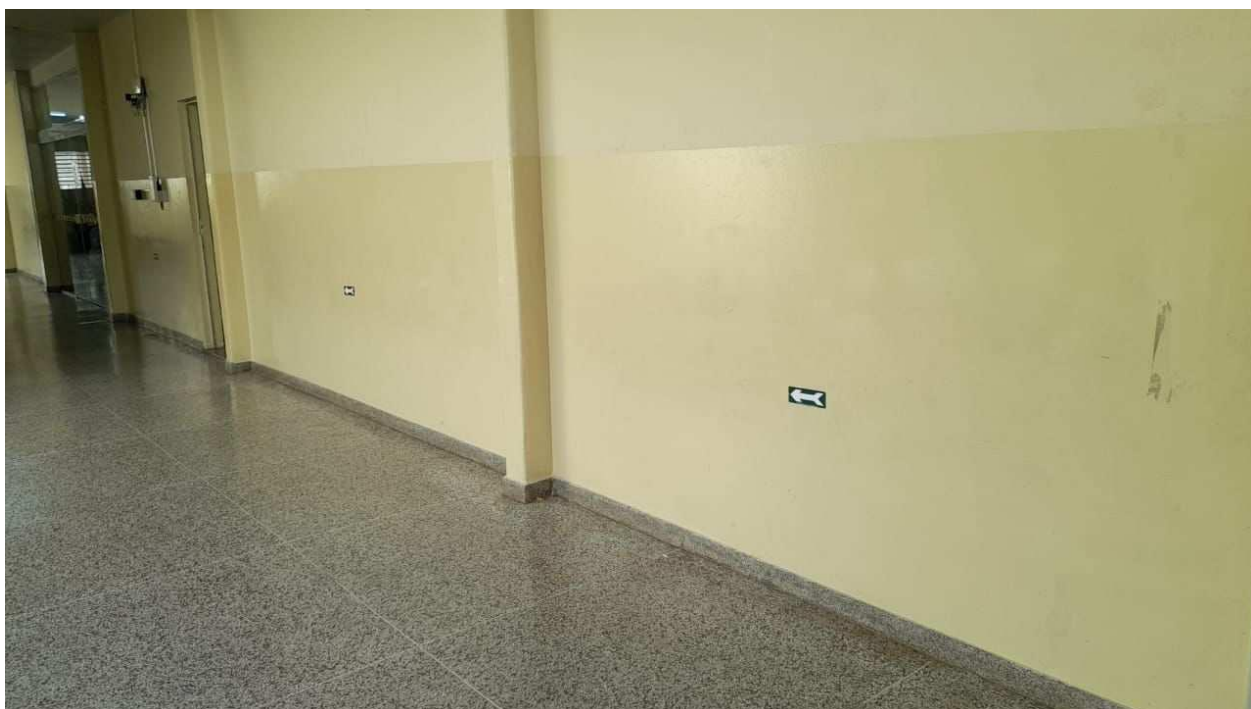
Figura 17- CORREDOR COM SINALIZAÇÃO ROTA DE FUGA 2
