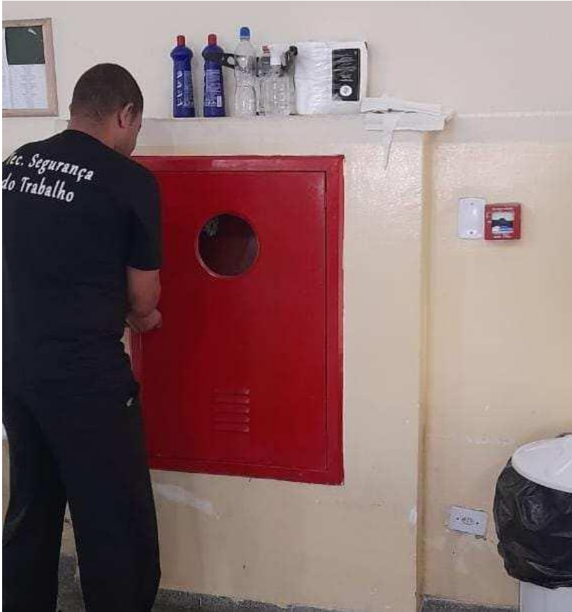
Figura 7- VISTORIA NO HIDRANTE
