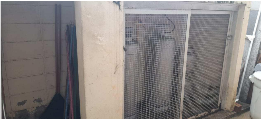
Figura 5- CENTRAL DE GLP
