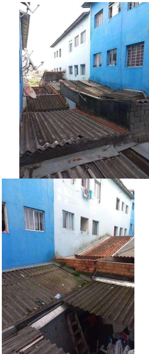
Fig. Construções irregulares no recuo de fundo
