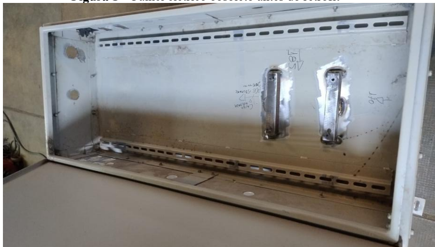
Figura 1 – Painel elétrico obsoleto antes do retrofit
