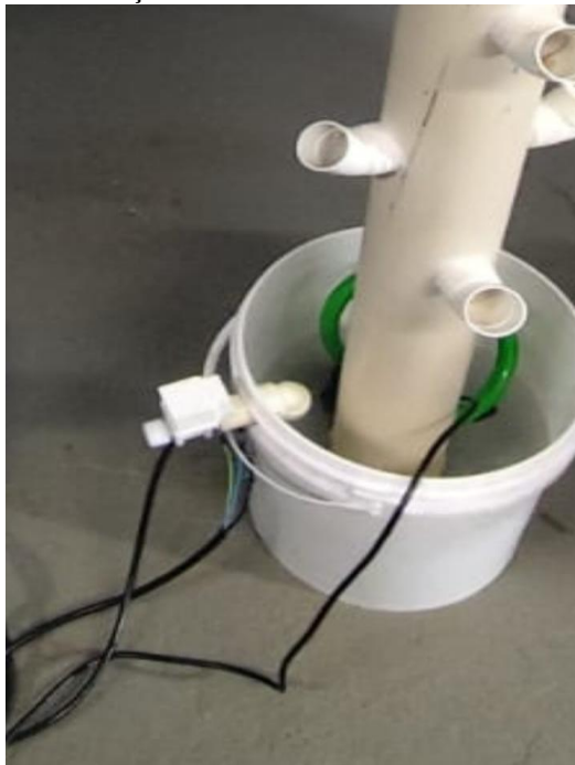
Figura 31 – Demonstração da bomba instalada e sistema de recirculação
