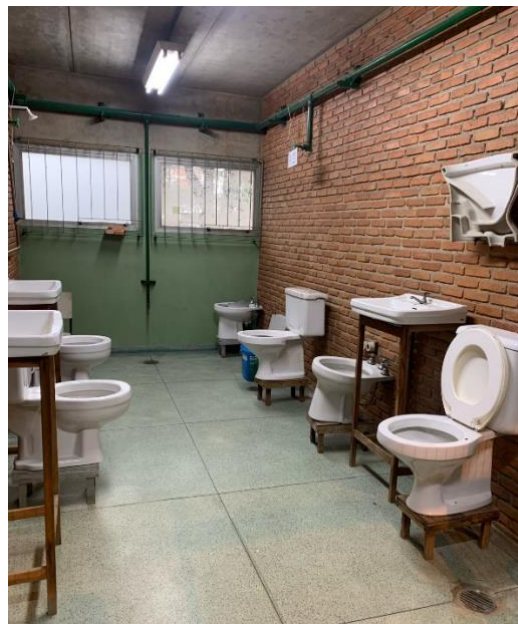
Figura 19. Laboratório de Instalações Hidráulicas – piso térreo
