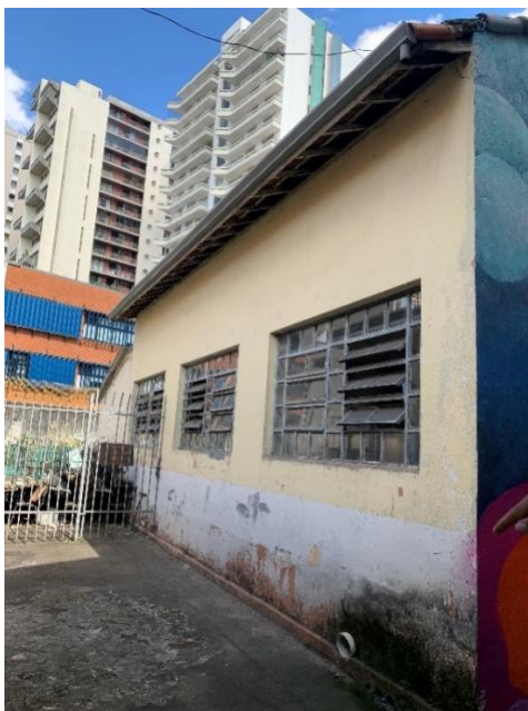
Figura 43. Parede lateral esquerda do Bloco D
