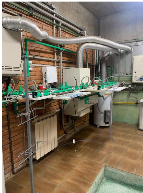
Figura 22. Laboratório de Instalações Hidráulicas – piso térreo
