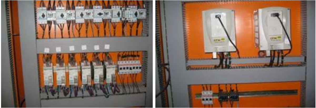
FIGURA 34 - Detalhe do painel: relés inteligentes e inversores de frequência.
