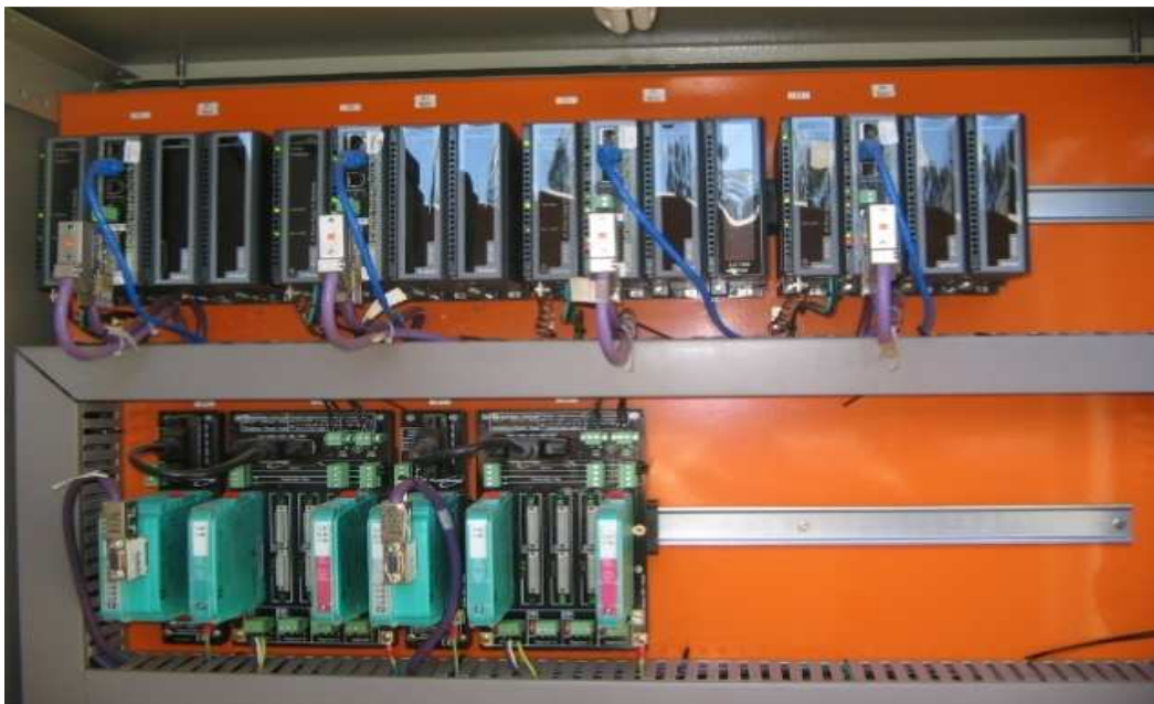
FIGURA 35: Detalhe do painel: controladores, gateways e acopladores.
