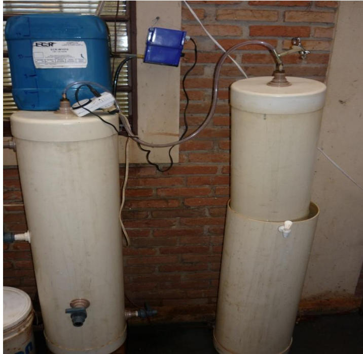
FIGURA 12 – Reator UASB montado e em operação.
