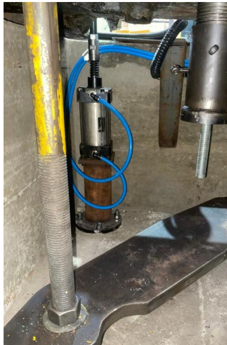
Figura 05 – Pistão pneumático instalado no poço da prensa
