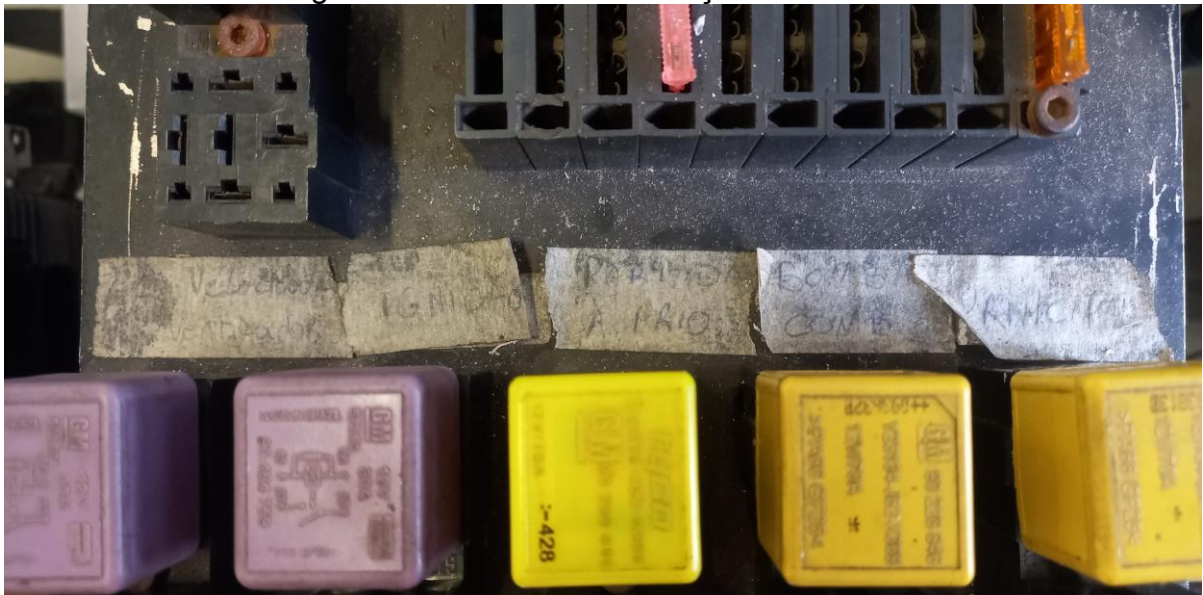
Figura 26- Placa de identificação deteriorada
