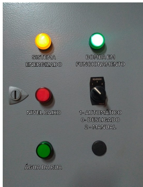
Figura 5 – Pannel elétrico e de automação do sistema
