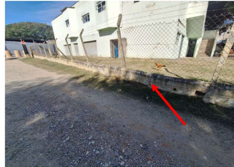
Manifestações patológicas no alambrado próximo ao córrego
