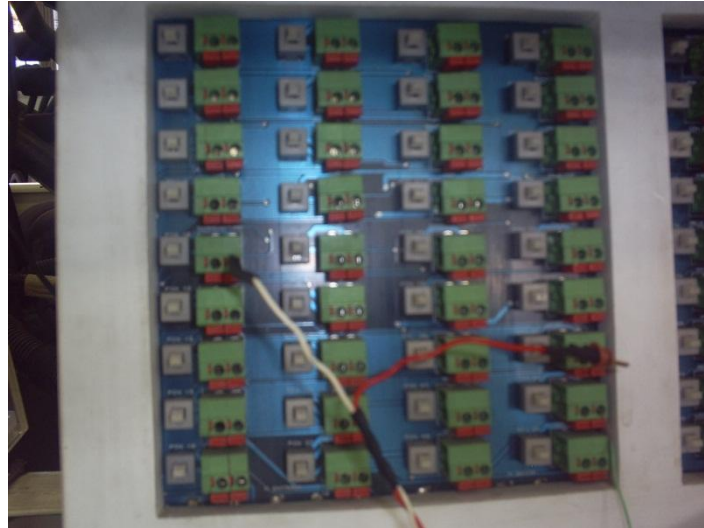
Figura 61 - Painel para Acesso a Sensores do MOCK-UP.
