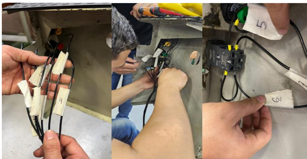
Figura 41: Fiação dos sinaleiros.
