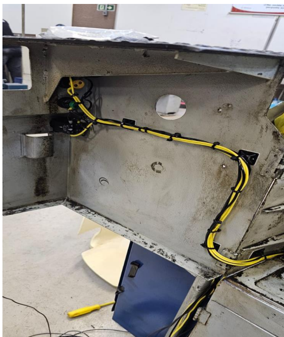
Figura 42: Organização dos cabos dos sinaleiros e botão de impulso.
