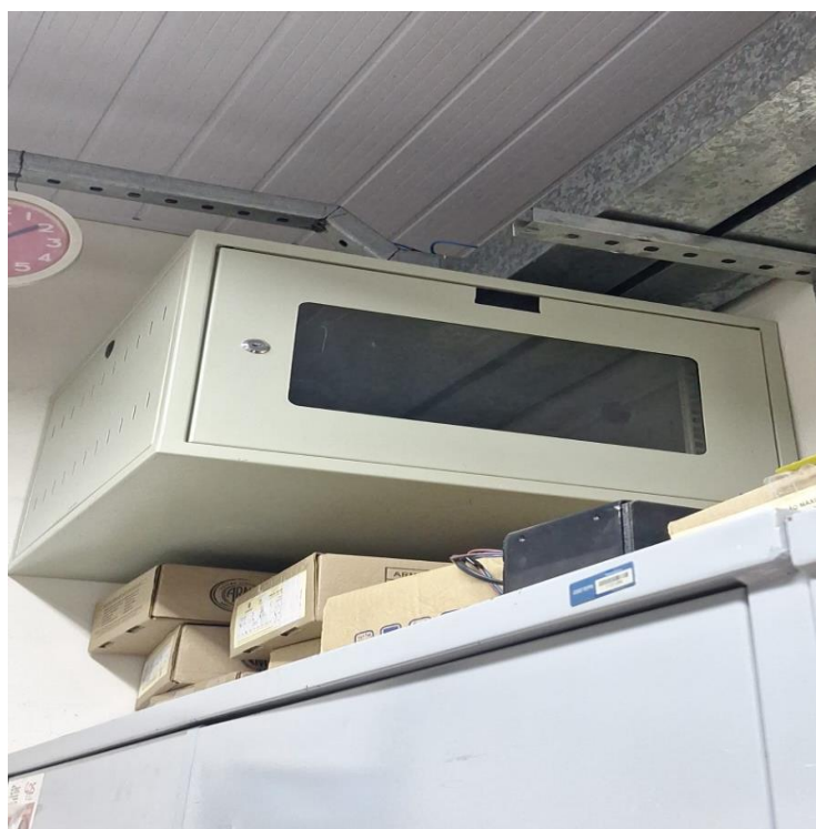
Figura 7: Modelo de Rack que foi utilizado no projeto FONTE: Do Próprio Autor, 2025
