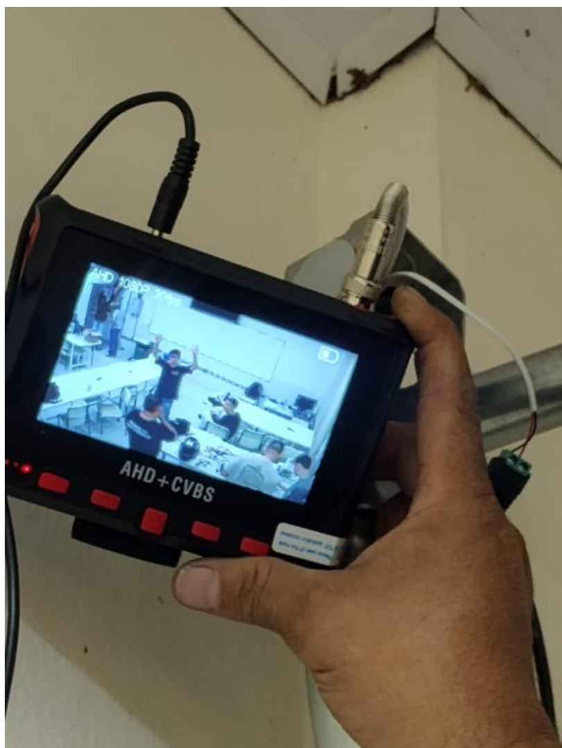
Figura 27: Teste com o testador de CFTV FONTE: Do Próprio Autor, 2025
