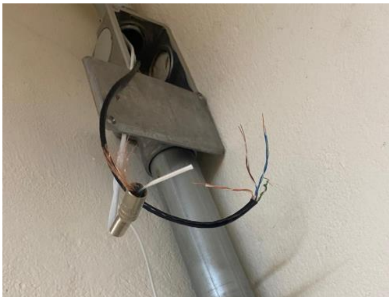
Figura 25: Conexão dos conectores BNC FONTE: Do Próprio Autor, 2025
