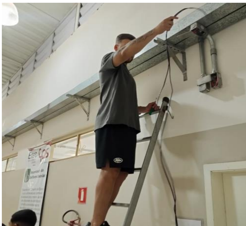
Figura 22: Realizando o lançamento do guia destinado à passagem dos cabos de rede e coaxiais
