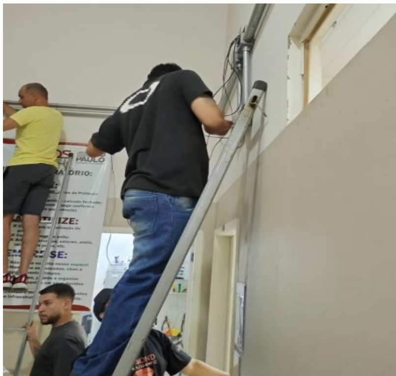
Figura 21: Realizando o lançamento do guia destinado à passagem dos cabos de rede e coaxiais
