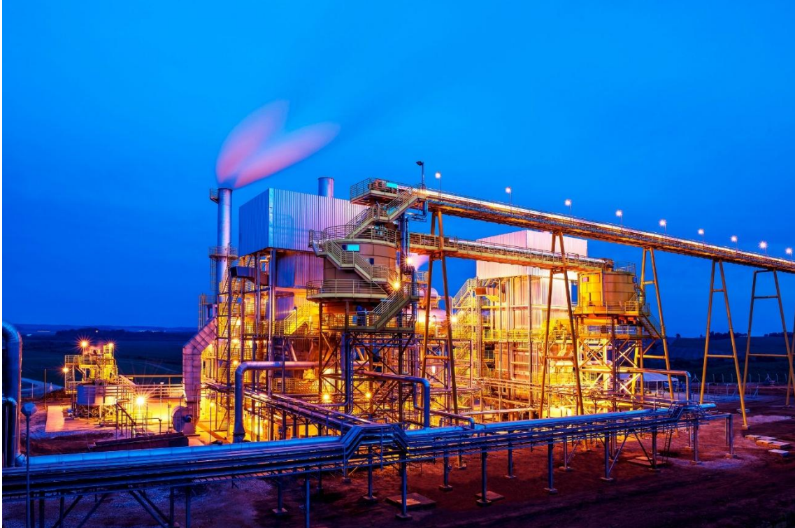
Figura 8. Caldeira Aquatubular I
