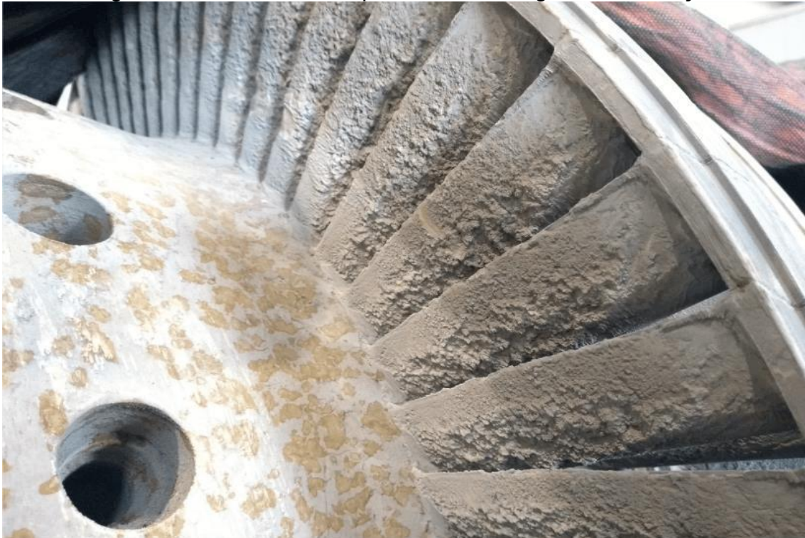
Figura 13. Turbina com as palhetas em estágio de incrustação
