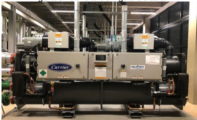
Figura 3: Central de Água Gelada.
