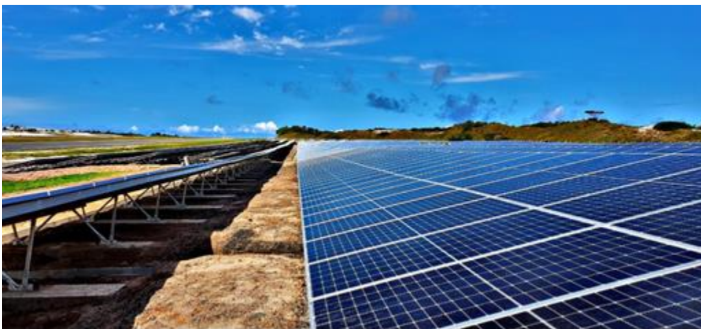
Figura 2: Usina solar localizada no aeroporto.
