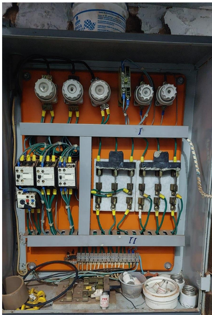
Figura 4. Painel elétrico original do sistema de bombeamento, evidenciando desorganização e componentes obsoletos
