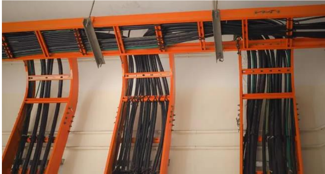
Figura 2 - Cabos de distribuição elétrica de um prédio. Fonte: AECWeb
