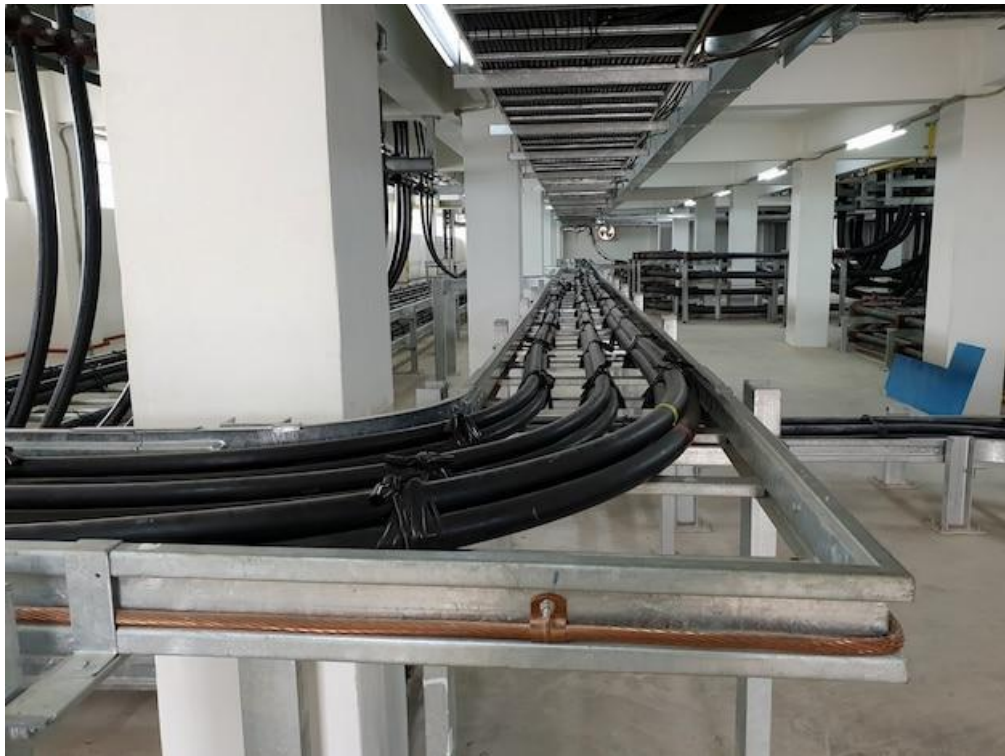
Figura 1 - Cabos de cobre de distribuição elétrica de um prédio. Fonte: AECWeb
