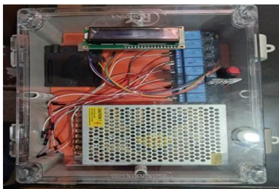
Figura 38 - Painel de Comando
