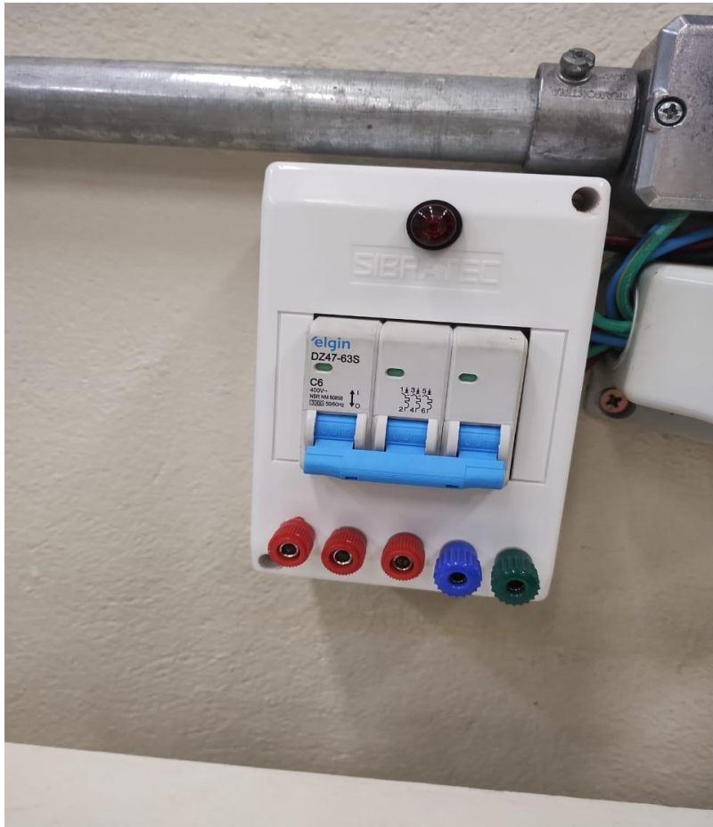
Sistema Não Energizado
