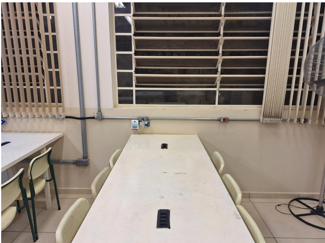
Figura 30: Instalação elétrica depois das adequações FONTE: Próprio Autor (2025)
