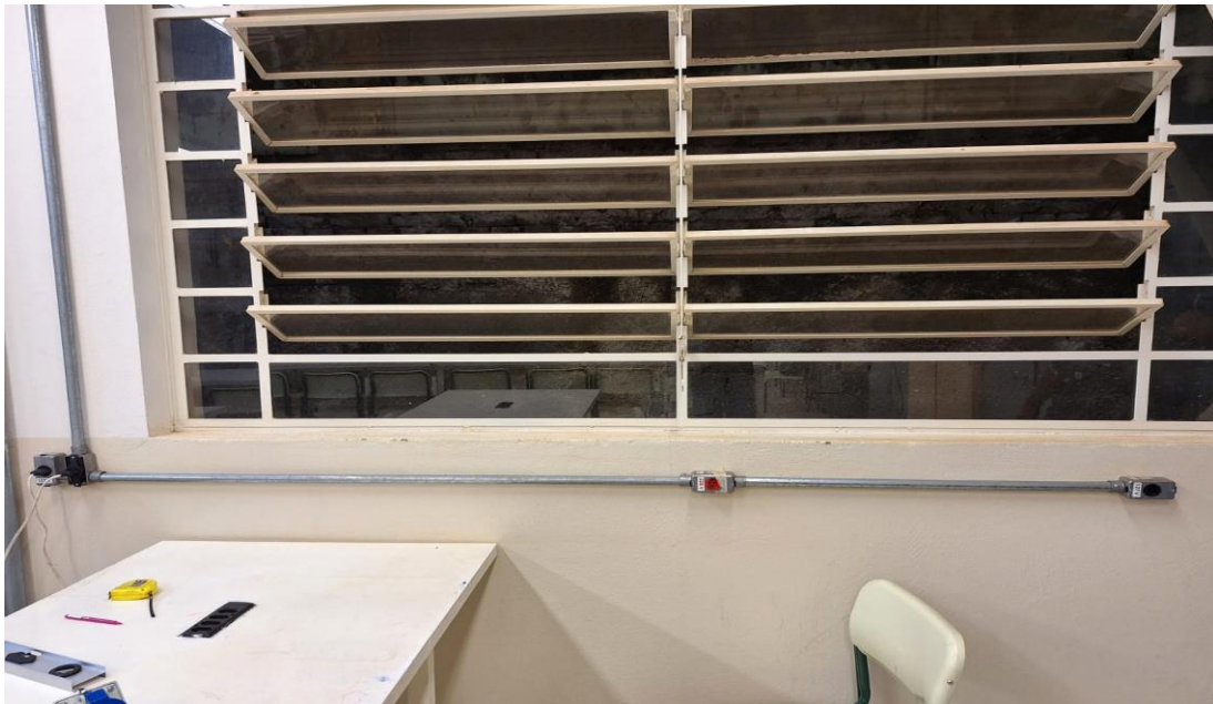
Figura 29: Instalação elétrica antes das adequações FONTE: Próprio Autor (2025)
