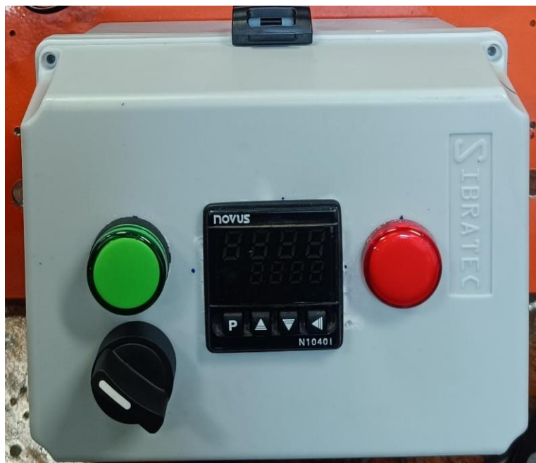
FIGURA 32– Painel de controle e sinalização FONTE: Do próprio autor, 2025
