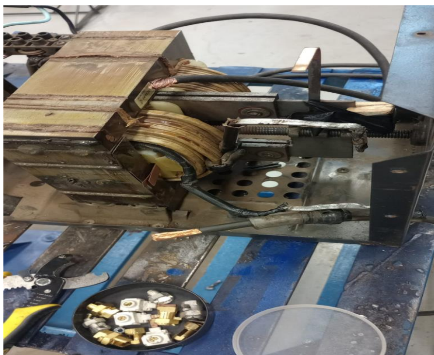
Figura 27: Cabos ressecados e rompidos FONTE: Do próprio Autor, 2025
