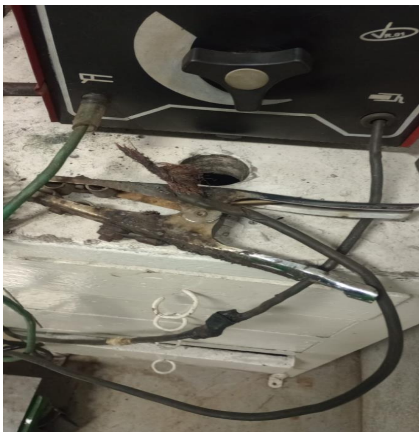
Figura 29: Garra negativa danificada FONTE: Do próprio Autor, 2025
