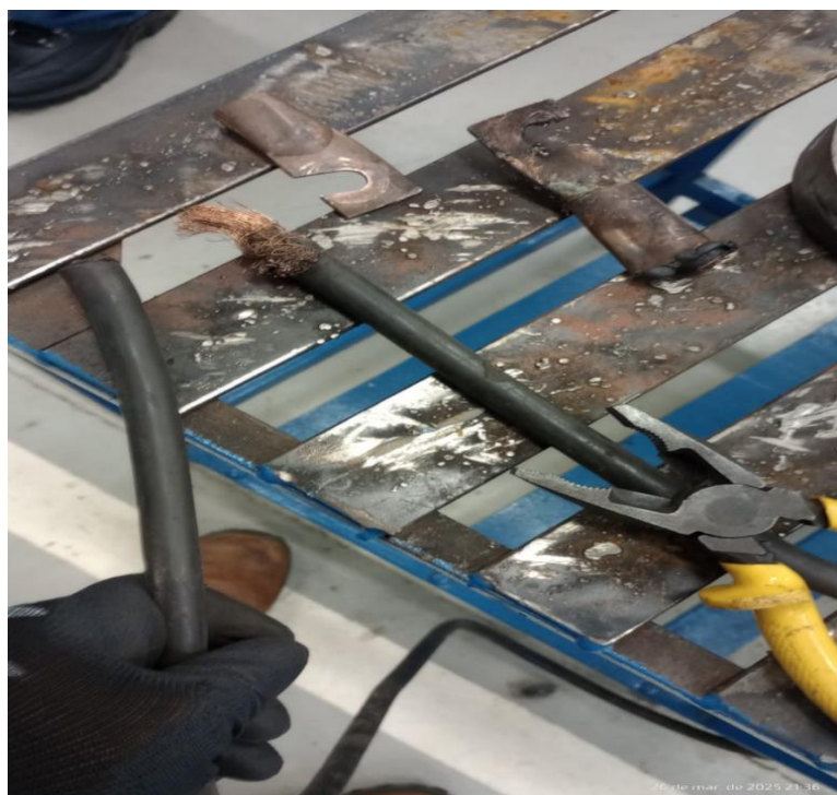
Figura 23: Cabos e Conectores Danificados FONTE: Do próprio Autor, 2025
