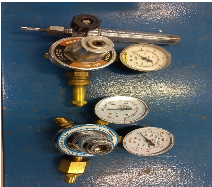
Figura 18: Manômetro com defeito FONTE: Do próprio Autor, 2025
