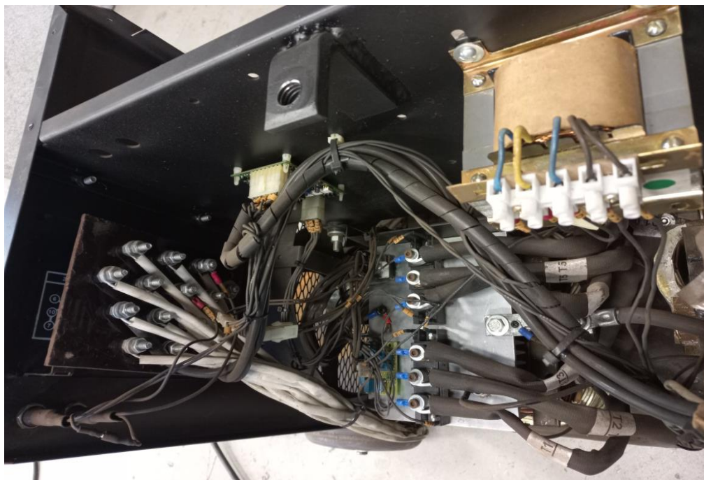
Figura 22: Organização dos cabos FONTE: Do próprio Autor, 2025
