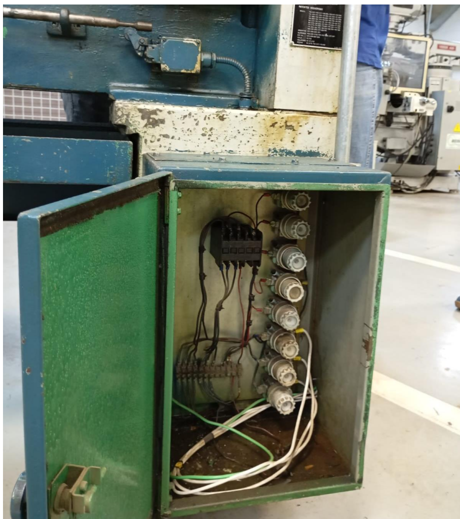
Figura 10: Torno com painel antigo FONTE: Próprio autor, 2025
