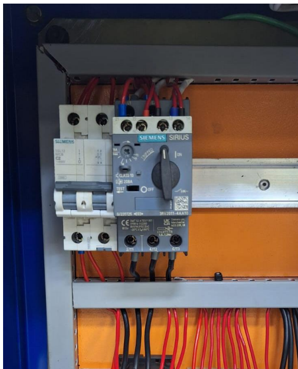
Figura: Disjuntor motor e disjuntor termomagnético FONTE: Próprio autor, 2025
