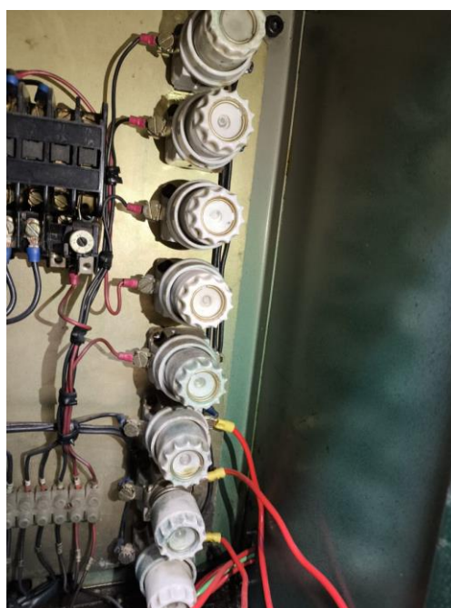
Figura 17: Fusíveis Diazed FONTE: Próprio autor, 2025
