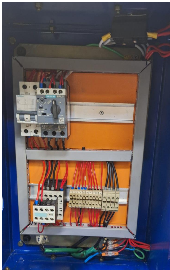
Figura 20: Painel novo FONTE: Próprio autor, 2025
