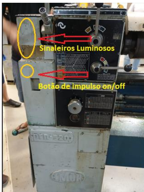
Figura 20: Instalação dos sinaleiros luminosos e do botão de impulso. FONTE: Próprio Autor (2025).
