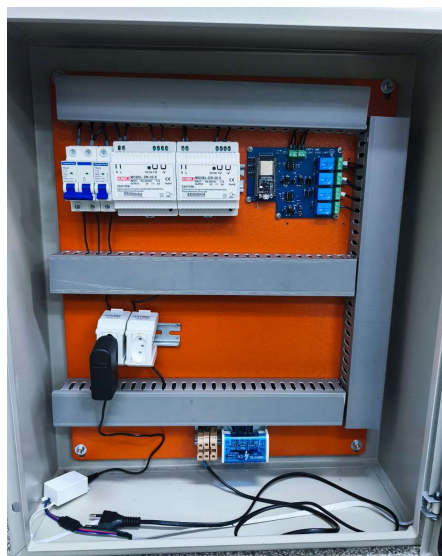
Figura 12 – Quadro elétrico montado para os testes do sistema IOTFY ONE.
