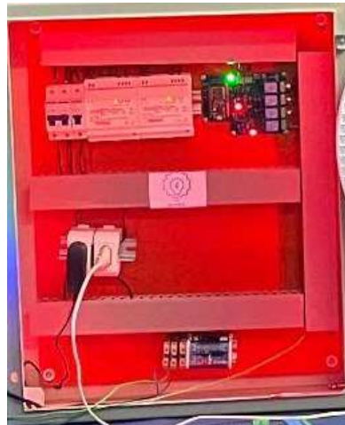
Figura 13 – Interior do quadro durante os testes
