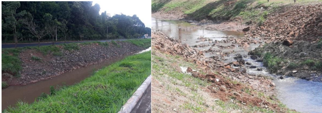
Figura 6 – Área com erosões cobertas com pedras produzindo solapamento e assoreando o córrego
