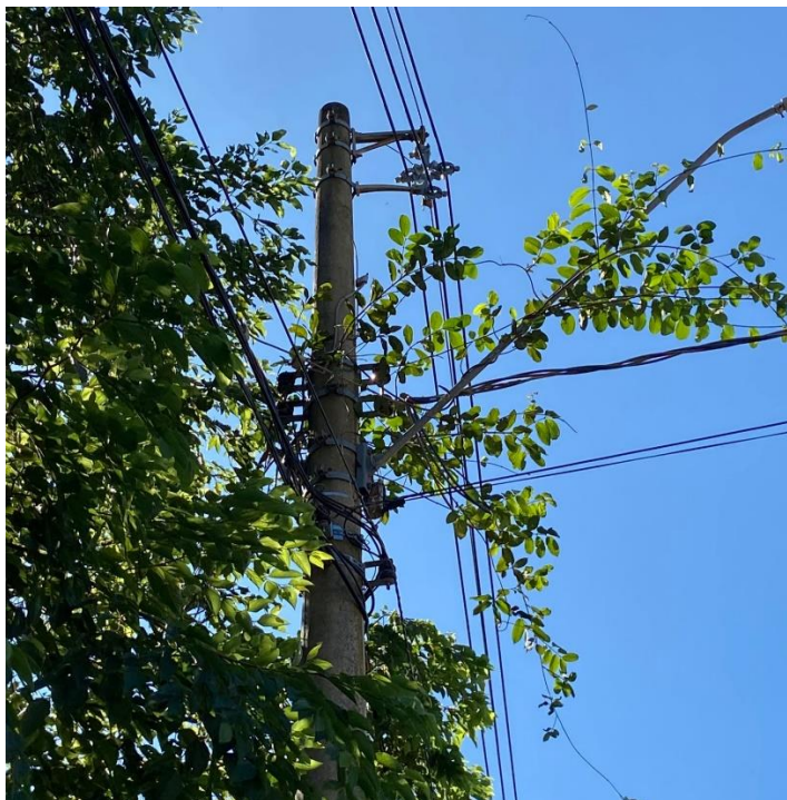
Imagem 8: Galhos enroscados na fiação devido à falta de poda
