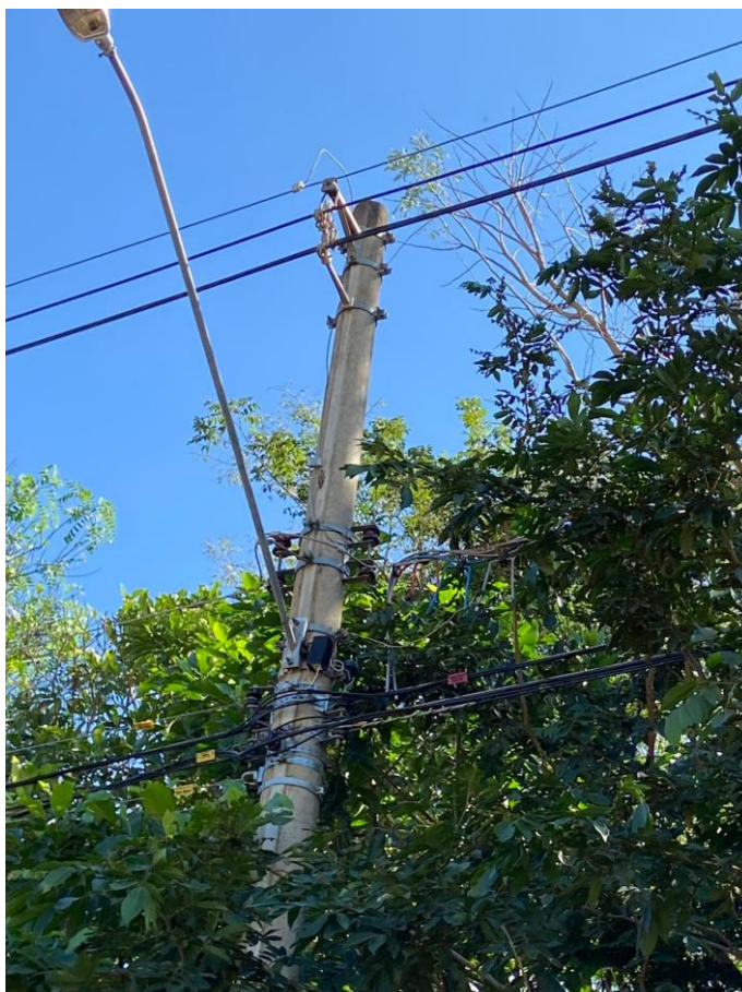
Imagem 9: Galhos enroscados na fiação devido à falta de poda.
