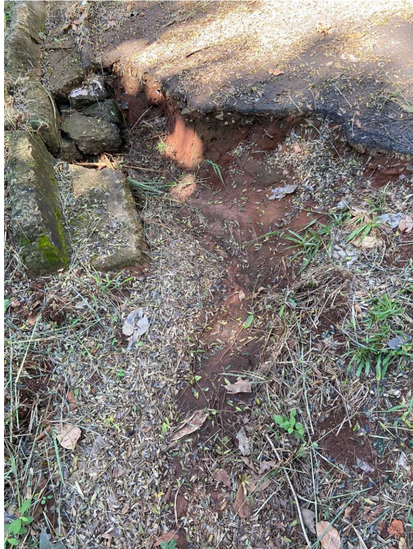
Imagem 10: Processo de erosão.
