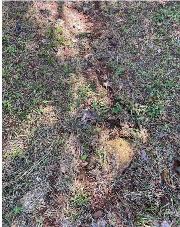
Imagem 11: Caminho da erosão.
