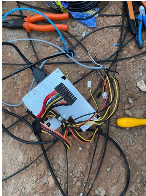
Imagem 20: Fonte de Alimentação instalada.
