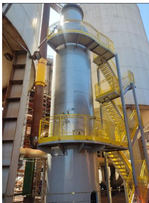
Figura 4 – Torre de recuperação de etanol instalada.
