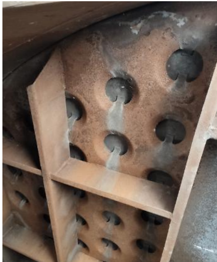
Figura 2 – Corrosão nos equipamentos.
