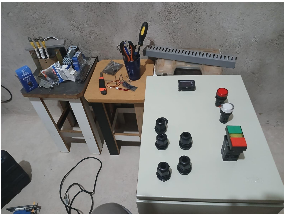
Figura 15 - Fonte Retificadora e Materiais de instalação
