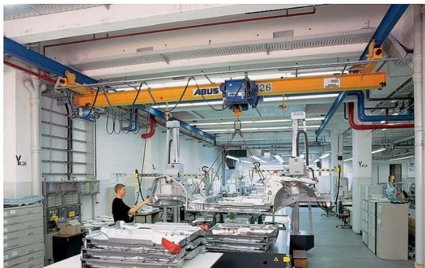
Figura 9: Ponte Rolante Suspensa
