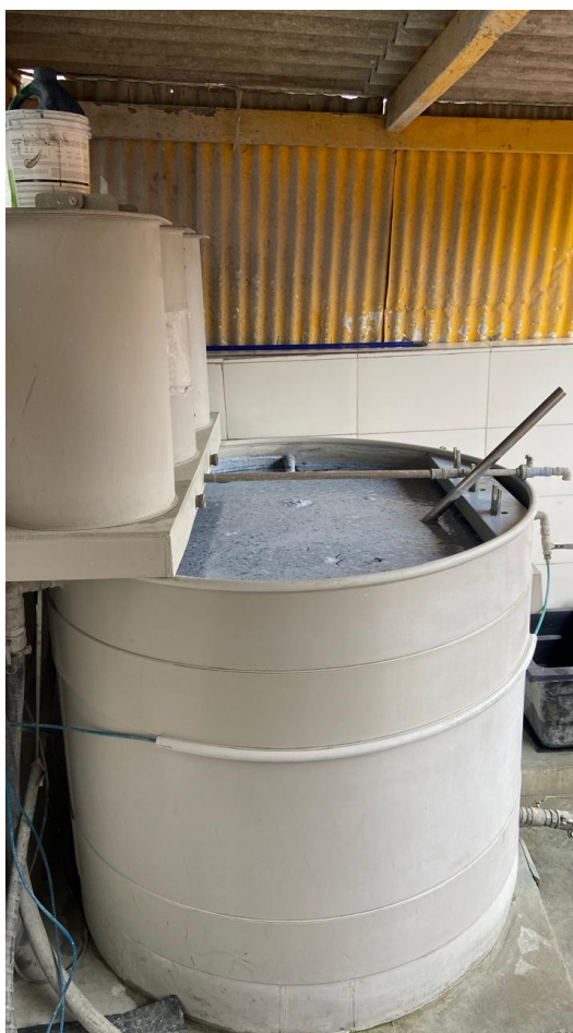
Fotografia 3 – Tanque de tratamento da água na empresa Tintas Irajá .
