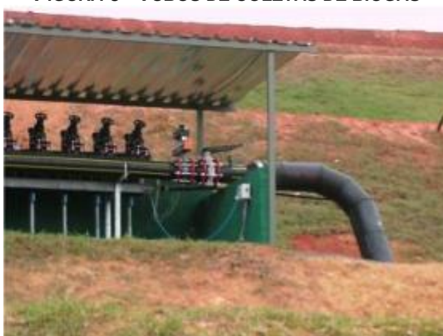
FIGURA 6 - TUBOS DE COLETAS DE BIOGÁS
