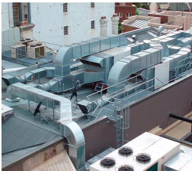
Figura 6 – Tubulações de ar rígidas.
