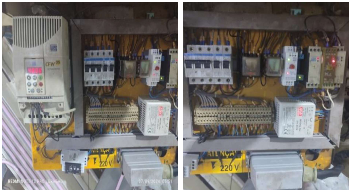
Figura 7 e 8: Painel do Circuito de Força
