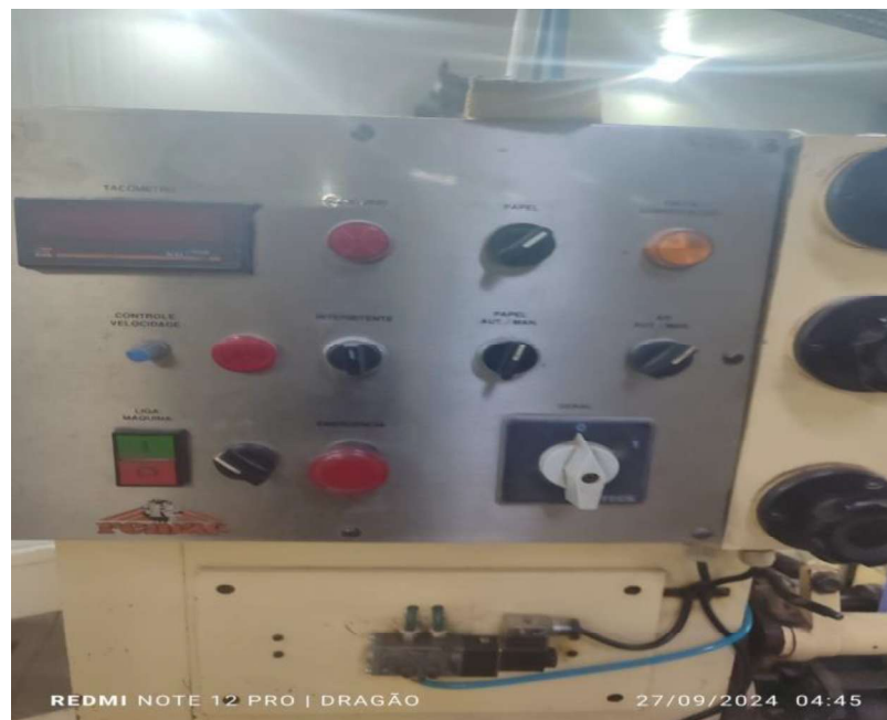
Figura 2: Painel de controle
