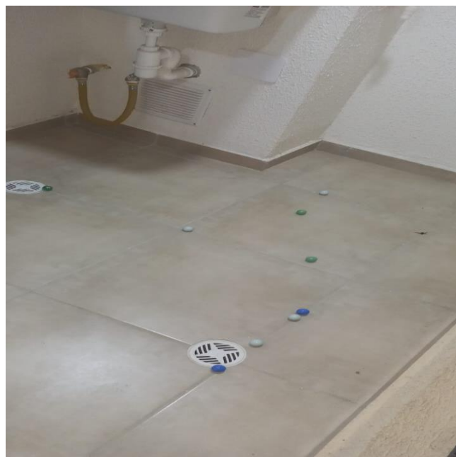
Figura 05 - Verificação de caída de água no ralo da varanda.
