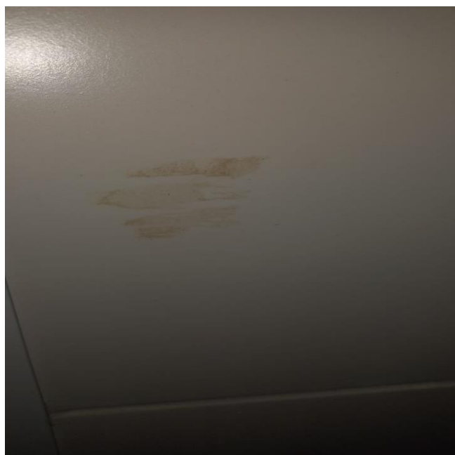
Figura 06 – manchas de cola em piso cerâmico.
