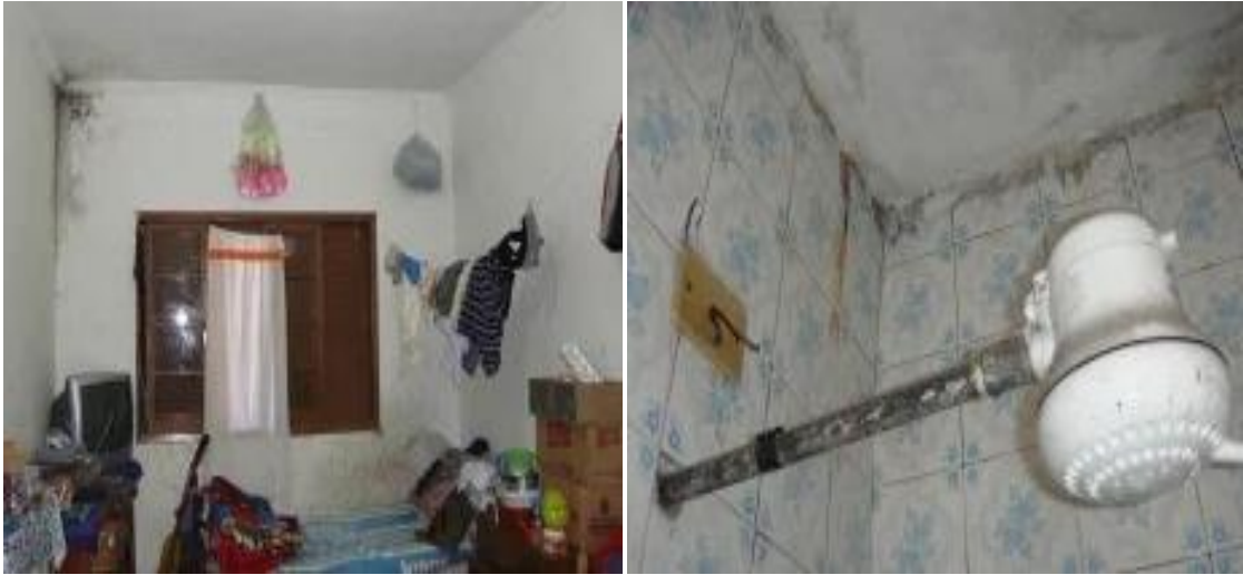
Figura 13 - Dormitórios precários e chuveiro desligado
