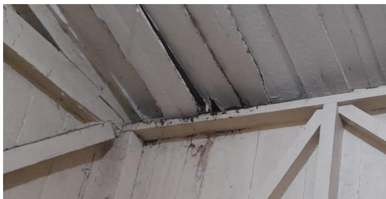
Imagem 8 - Patologia - Danificações na Cobertura
