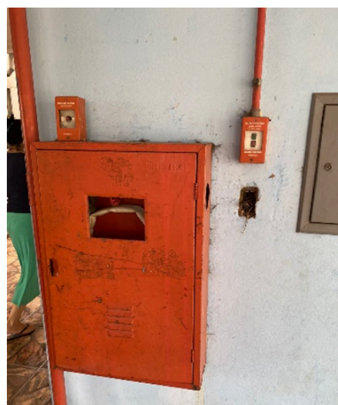
Figura 84: Falta de manutenção nos equipamentos
