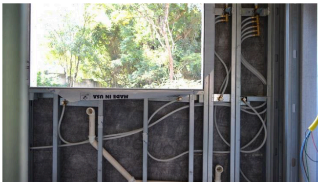
Figura 22: Instalação hidráulica Fonte: Google 2024
