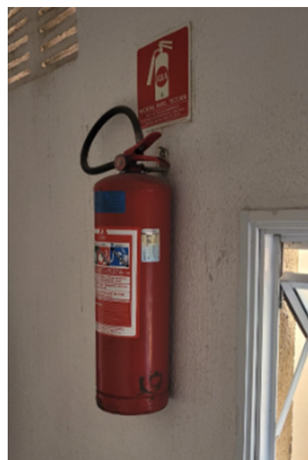
Figura 122: Equipamento de segurança contra incêndio. Fonte: do autor
