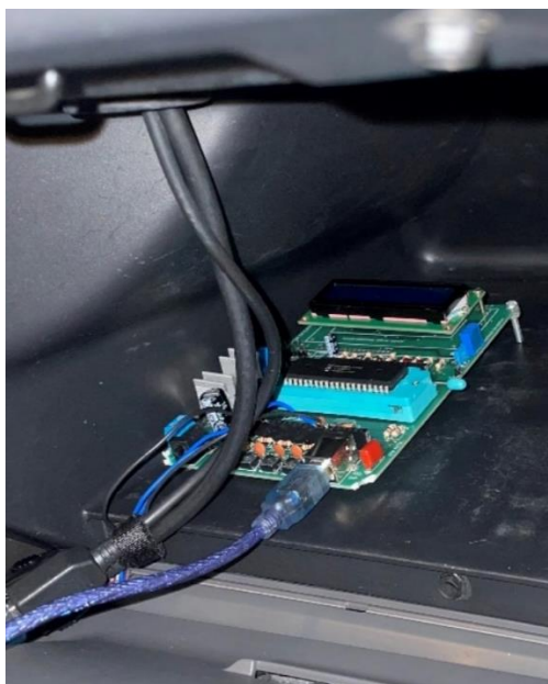
Figura 27 - Sistema de segurança de bateria automotiva instalado no porta-luvas
